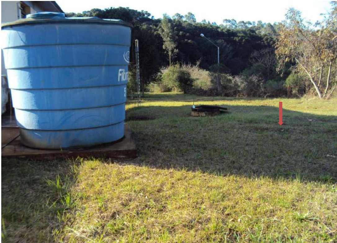
Figura 8: Reservatório subterrâneo com capacidade de 150 m 3 (R-1).
