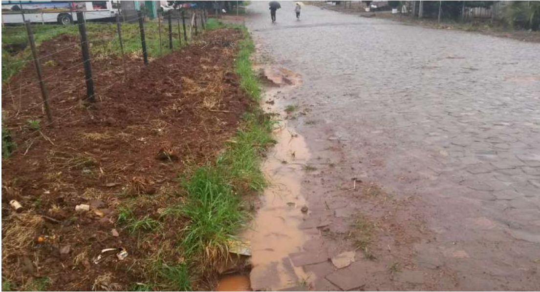
Figura 16: Escoamento de águas pluviais sobre a via, em local no qual não foi executado o passeio público.
