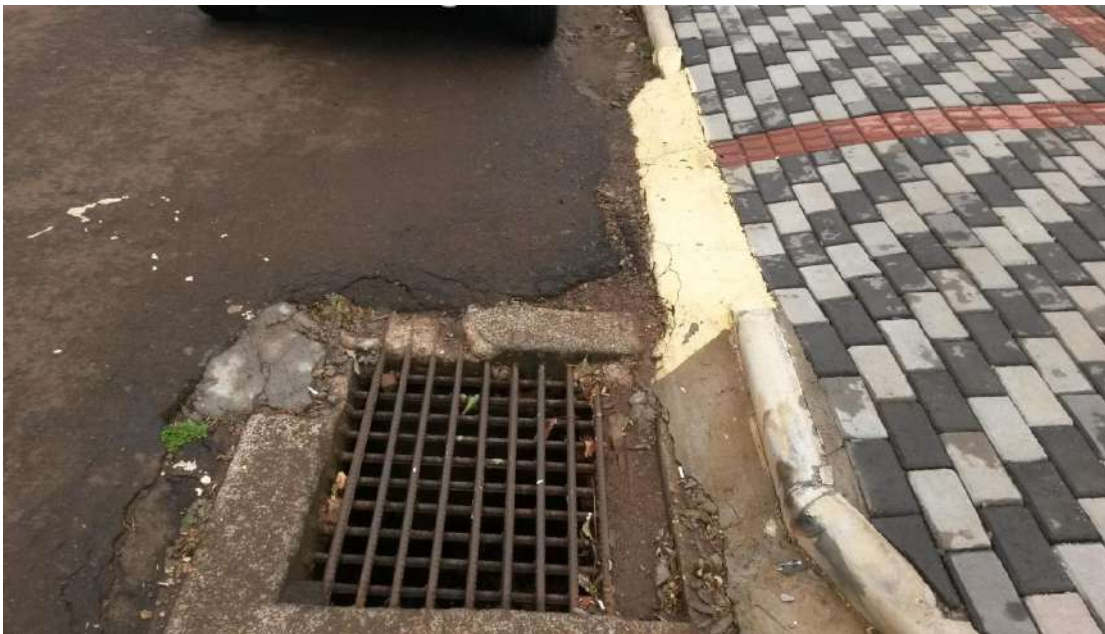
Figura 15: Grelha para captação das águas pluviais das vias.
